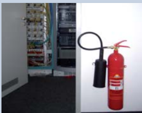
CO 2 -Feuerlöscher vor dem Serverraum
